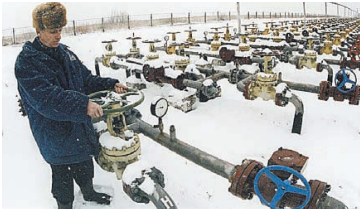
Tuberías - La energía provista por Rusia llega a ese país en gasoductos que cruzan hacia el resto del continente europeo.
