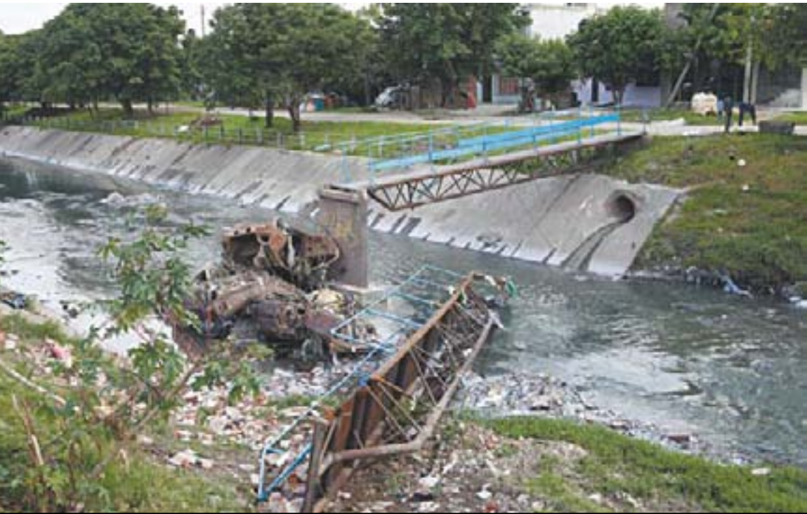
Derribado - El puente que divide a los barrios 9 de Julio y Libertador fue tirado abajo por los vecinos después del crimen.
