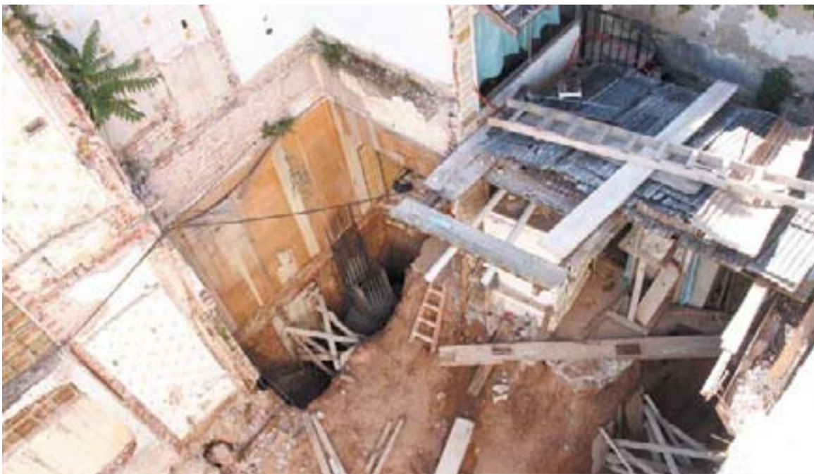
Ausencia - Los funcionarios dijeron que denunciarán al encargado de la obra por no estar presente en la excavación.
