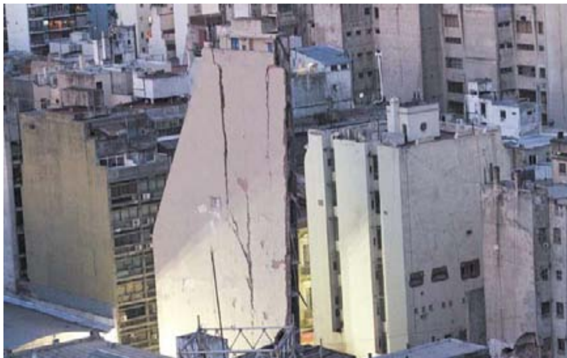
Colapso - La Ley 3562 pudo haber evitado el derrumbe del edificio de Bartolomé Mitre al 1200 y la pérdida de una vida.
