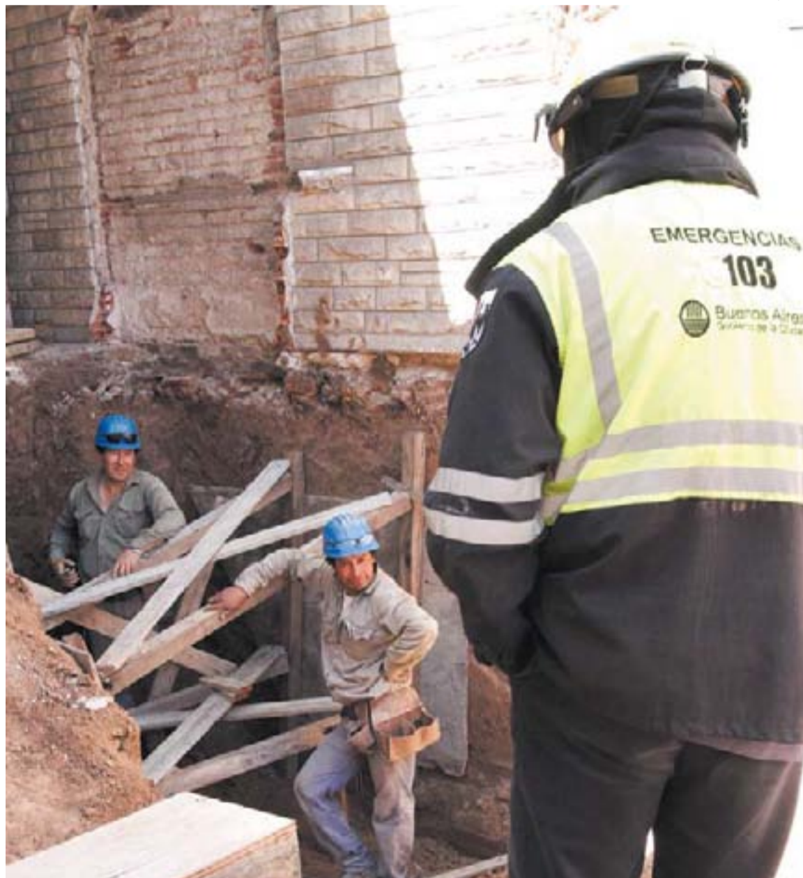
Clausura - La guardia de emergencias del gobierno porteño ordenó el apuntalamiento de las medianeras.
